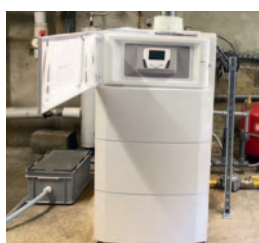
Nouvelle chaudière à condensation dans les locaux de la CCDSV.
