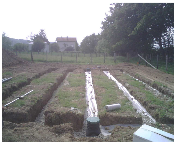
Exemple de tranchées d'épandage avant la mise en place de tuyaux de distribution et géotextiles (Isère)
