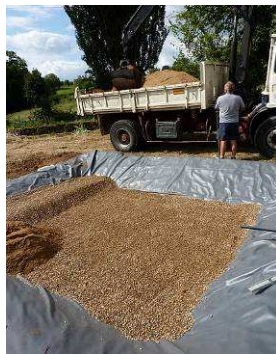
Mise en place du sable après les gravillons du fond du filtre vertical et du filtre horizontal
