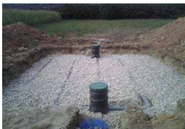
Mise en place de filtre à sable non drainé avant la pose du géotextile
