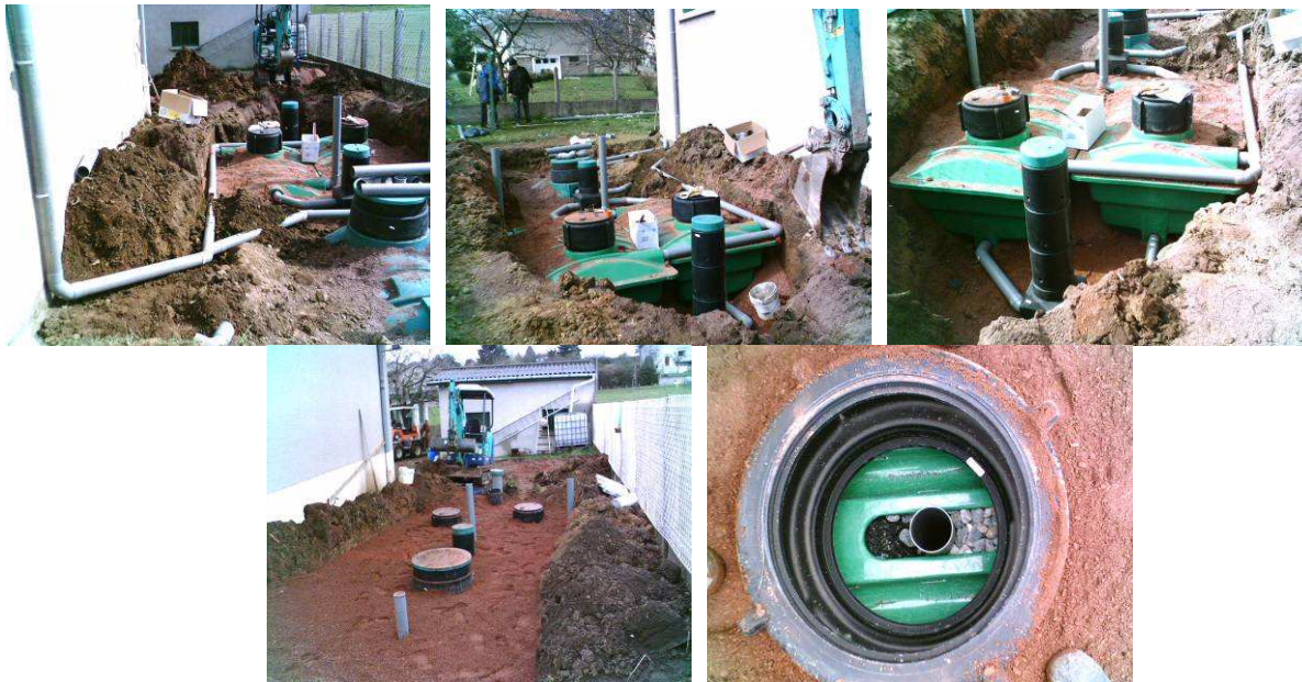
Mise en place d'un filtre à zéolite 3 (Isère)
