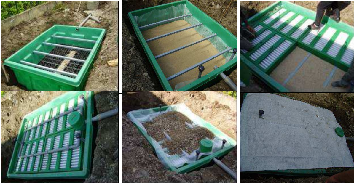
Mise en place d'un filtre à zéolite 2 (Isère)
